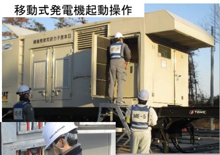
移動式発電機起動操作
