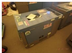
⑦可搬型発電機
